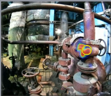
Нарушение герметизации фланцевых соединений
